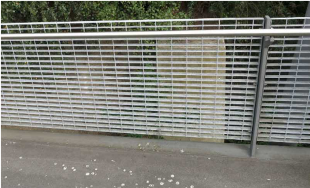
Figur 107 (foto Oskar Bruneby) Just räcke finns det hur många varianter som helst just här en bro i Oberhausen som har gallerduks räcke
