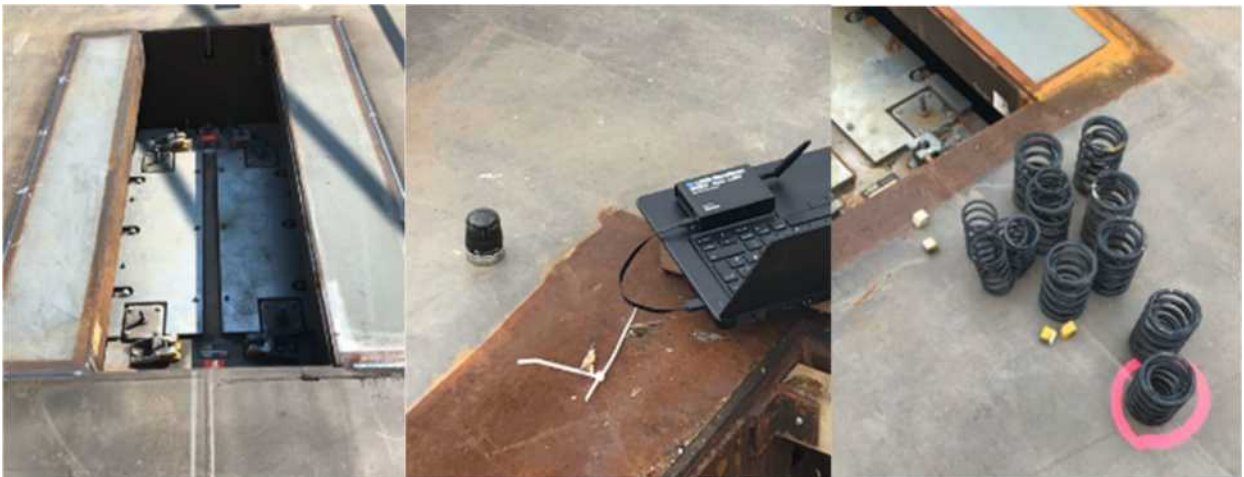
Figur 27 Exempel Hur man stämmer en bro Bilder (Foto Oskar Bruneby Varvsbron Helsingborg) Dämparen är i första läget dimensionerad med data från beräkningsmodell men behövs sedan finjusteras med hjälp av mätningar. Detta göres på plats med portabel utrustning. Sedan byter man fjädrar alternativt spänner hårdare så att man får maximal dämpning och Comfort.
