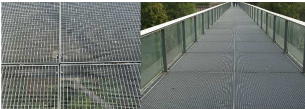
Figur 124 (Foto Oskar Bruneby) Visar durkplåtsbro som säkert har reducerad punktlast som byggherreval
