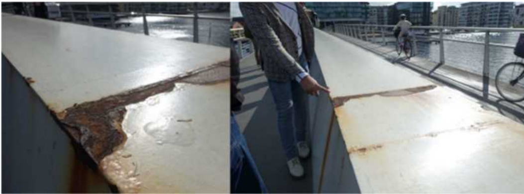
Figur 78 (Foto Oskar Bruneby) Visar korrosionsproblem på en montageskarv vid Lillelangerbro Köpenhamn på montagskrav 9 år gammal bron byggdes 2009 foto 2018. Ett målningssystem som bra utfört klarar 30-40 år normalt.
