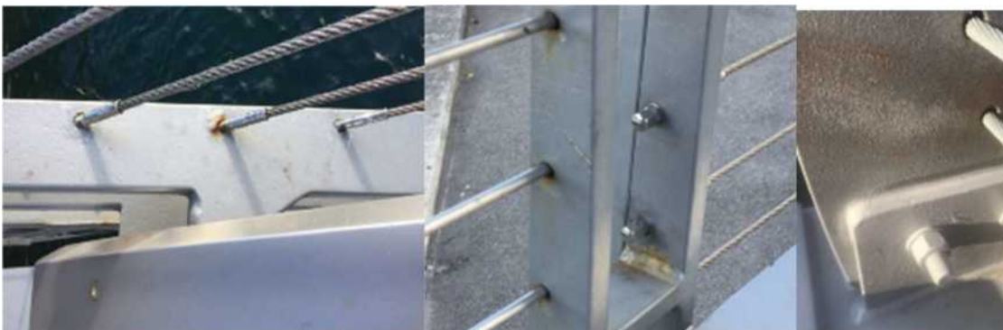
Figur 109 (foto Oskar Bruneby) Blanda inte material i onödan A och B Travallgarvasbroan Köpenhamn med många material och rostangrepp efter 3 år. C Tullportsbron bara i galv efter 5 År.
