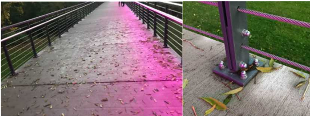
Figur 108 (foto Oskar Bruneby) Vajerräcke med infästning av räkesstolpe med kupolmuttrar
