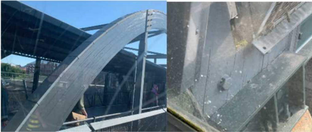
Figur 86 (foto Oskar Bruneby) Visar viskar delamination vid mindre bra inbygg bågbro vid Lundstation
