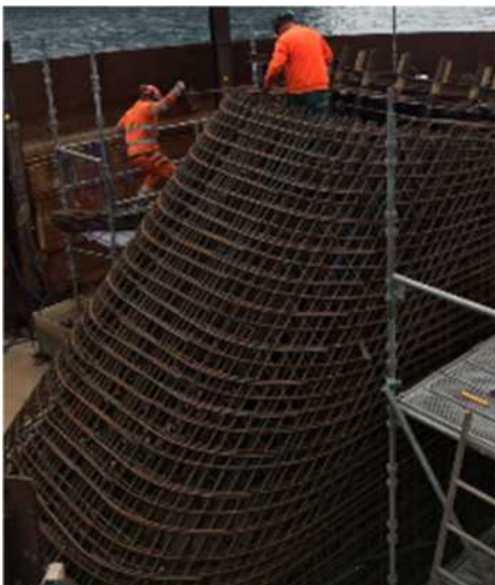
Figurer 148 (foto Oskar. Bruneby) Visar koniskt elliptiskt fundament som krävde stor insats att bygga och ca dubbel kostnad per m 3 mot ett fundament som kunnat beskrivits med normal geometri. Det blir fint men man bör se över geometrin för kostnadseffektiviteten.
