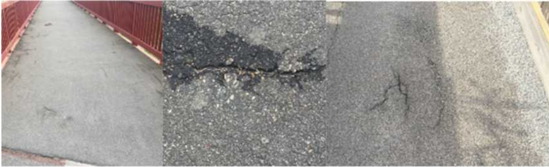
Figur 120 (Foto Oskar Bruneby) Asfaltsbeläggningar på typ 20 år gamla träbroar som också har problem vid bortslut med övergång som inte klarar sig utan grusskifte som man kan tro.
