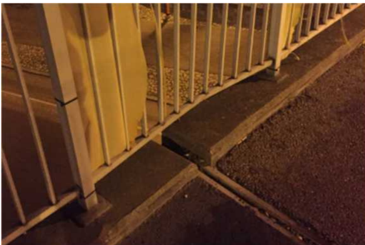
Figur 112 (foto Oskar Bruneby) Visar att det krävs detaljlösningar vid övergångskonstruktionen
