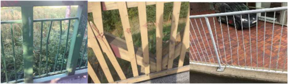
Figur 110 (foto Oskar Bruneby) Under studie av gångbroar kan man konstatera att ca 30% av gångbroar har defekter på räck så robusthet och service är viktigt.
