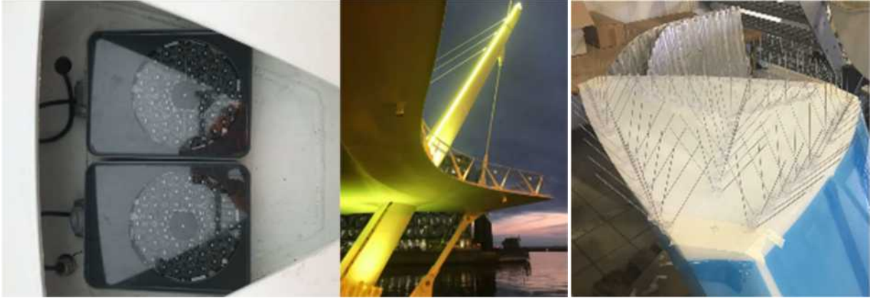
Figur 139 (foto Oskar Bruneby) Belysning i toppen på Varvsbron är det dyrt att byta lampa och har problem med måsars spillning, detta löstes med dubbla lampor med dubbel matning och fågelskydd.
