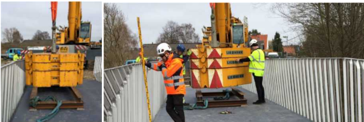
Bilder 25 (Foto Oskar Bruneby Kolfiber bro 254) Deformationsprov i skarpt läge med dimensionerade servicefordon. Detta görs enkelt med jigg och mobilkrans vikter
