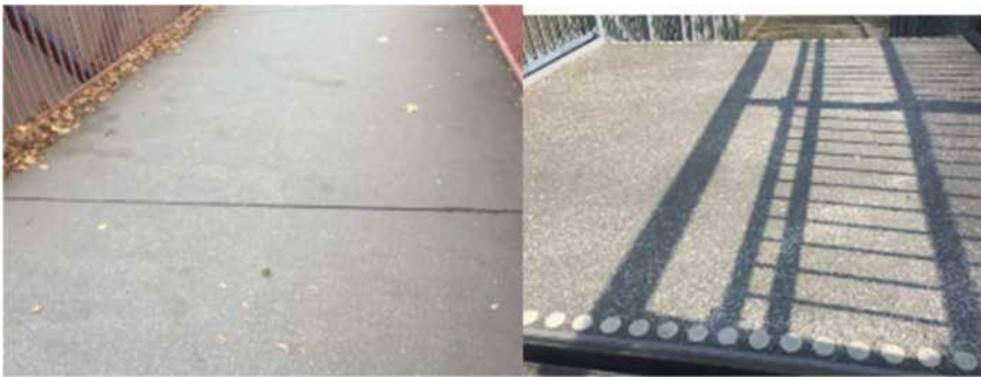
Figur 121 (Foto Oskar Bruneby) Asfaltsbeläggningar på typ 20 år gamla träbroar som också har problem vid bortslut med övergång som inte klarar sig utan grusskifte som man kan tro.
