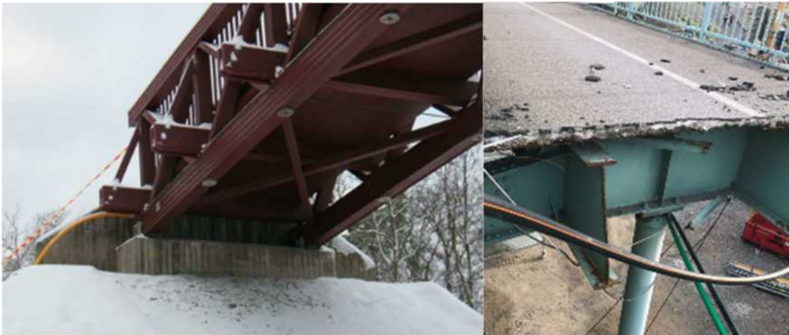
Figur 29 (foto Oskar Bruneby) A. Visar hur fackverksbro i trä har en bygghöjd på ca 1m och på det sätt tappar man fackverkskonstruktionens finess. Dessutom är träet väldigt känsligt för väder och är en lätt bro med fri höjd 5,2 m över vägtrafik. B Visar samverkansbro som får stålets underhåll och betongens tyngd och är ändå en lätt bro som har fri höjd 5,2 m över vägtrafik.
