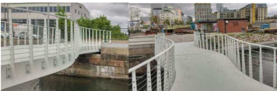
Figur 93 (foto Oskar Bruneby) Det finns en Fibercore bro i Malmö som byggdes 2018 och vid snabbare inspektion 2024 kunde inga synliga problem konstateras.
