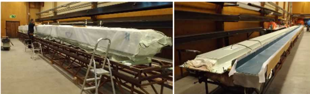
Figur 97 (Foto Oskar Bruneby). Sammanfogning av kärna i lättbetong och bygge av sidor i kolfiber
