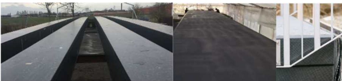
Figur 100 (Foto Oskar Bruneby). Sammanfogning samtliga komponenter till en bro. Balkar limmas samman. beläggningsarbete med sand inblandad Polyrea, Räcke och detaljarbetet vid övergång.
