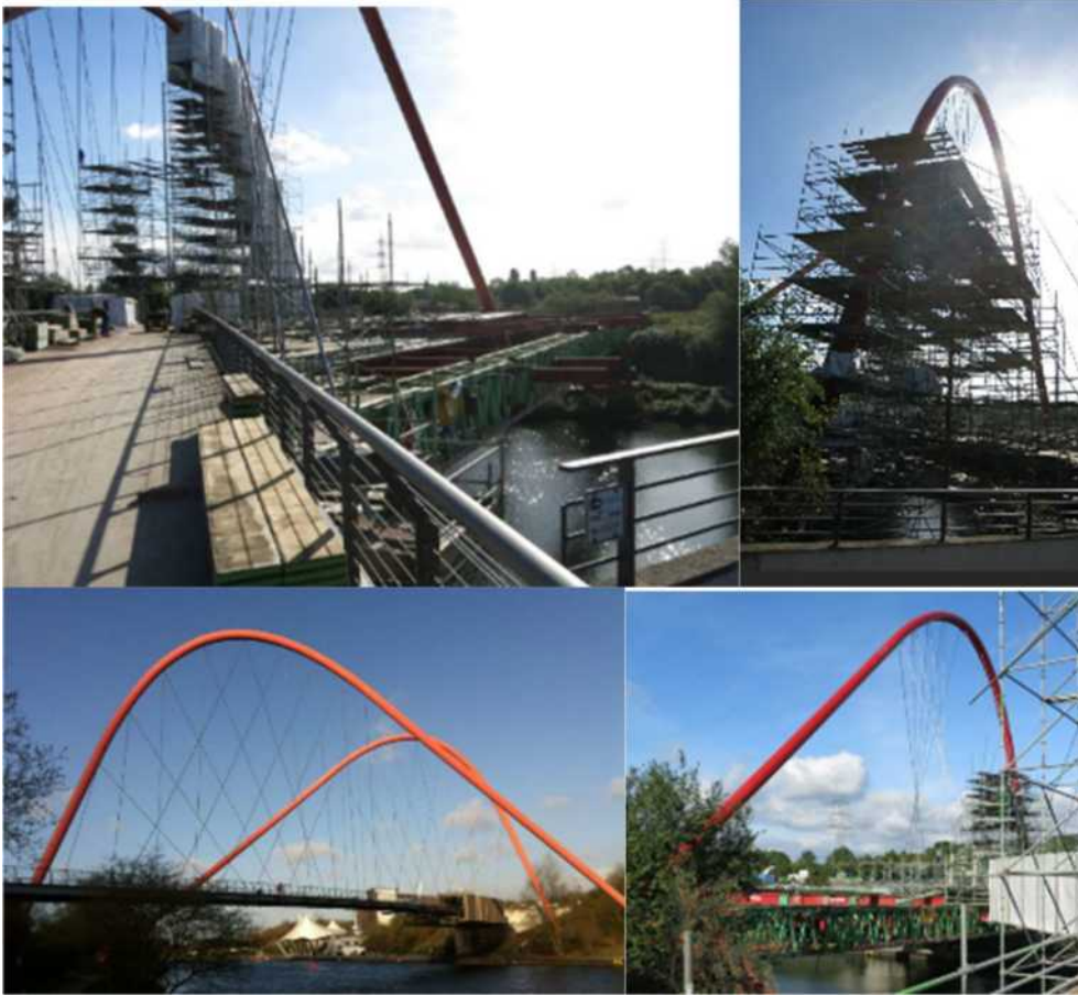
Figur 82(foto Oskar Bruneby) Visar den asymmetriska bågbron i Gelsenkirchen Tyskland som målades byggdes 1997 och målades om 2013 med väldigt avancerade provisorier då bågarna är 36 meter höga.
