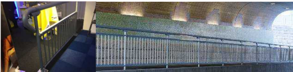
Figur 101 (foto Oskar Bruneby) Exempel på CE-märkt räcke. A visar räcke med höjd 1400mm för cykel. B Visar 1200mm förgångtrafik. Detta kostar ca 4000kr/m
