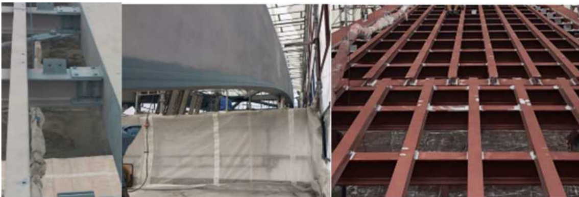
Figur 79 (foto Oskar Bruneby) Fotot visa kompletterande penselstrykning på Tullportsbron Ängelholm 2018 i olika lager för att upp nå 320 my på alla ställen.
