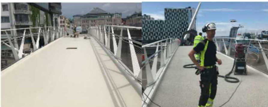
Figur 123 (Foto Oskar Bruneby) Beläggning varvsbron 10 mm tjock och glad beläggningentreprenör gör slutfinish.
